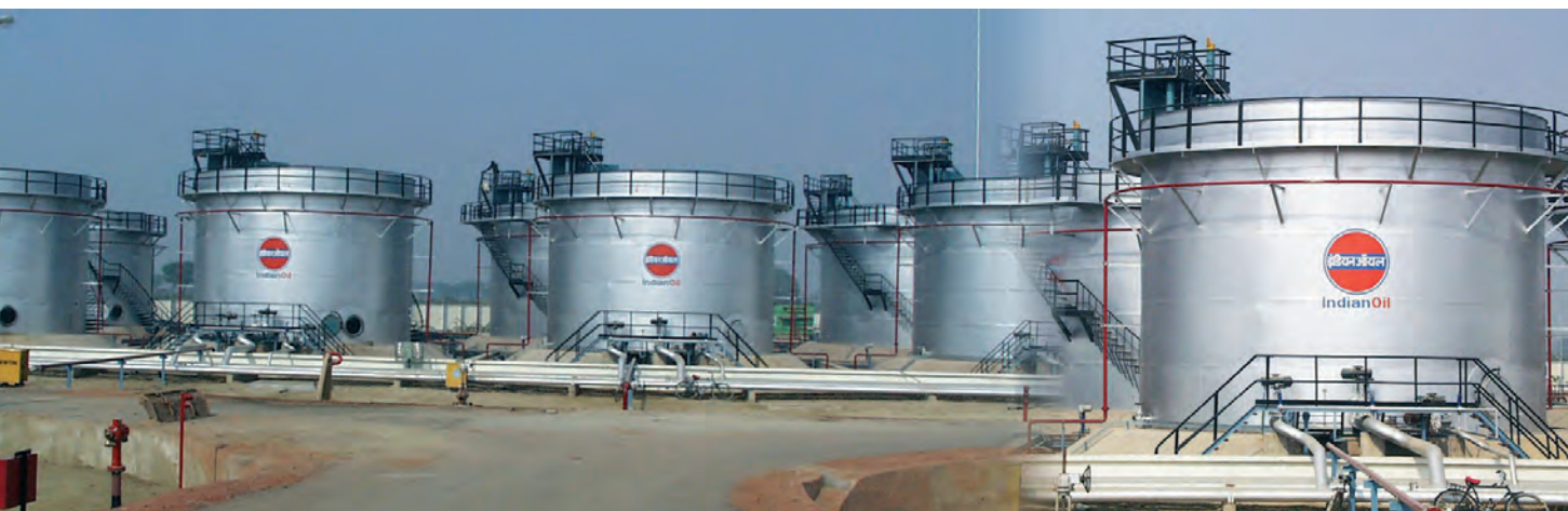
Резервуары для хранения нефтепродуктов Indian Oil
