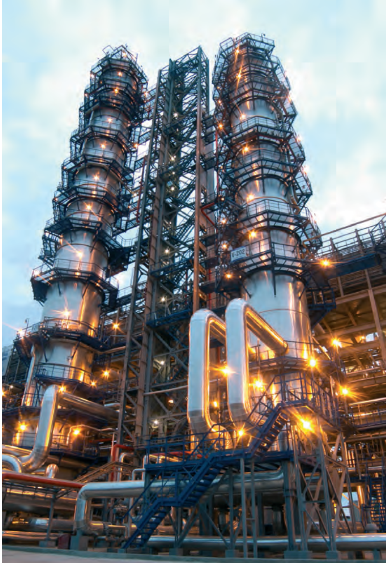
Установка по производству водорода, Московский НПЗ Источник: «Газпром нефть»
